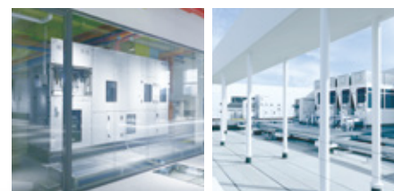
11 运行产品区（室内 / 室外）
