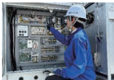
空調機制御盤点検
