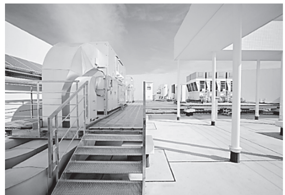
写真-7 屋上機器展示スペース
