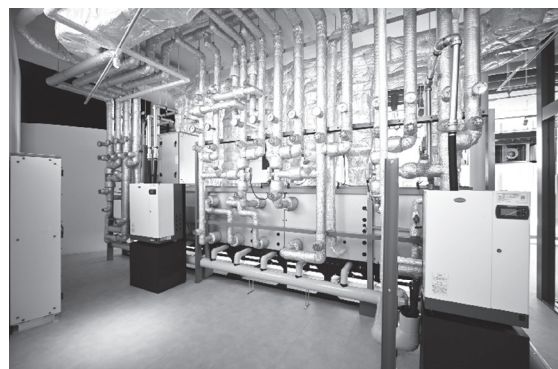
写真-10 体感ルーム用空調機 (背面)
